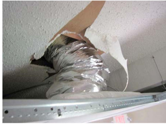
(d) Textured Ceiling Finish in Plenum C4
