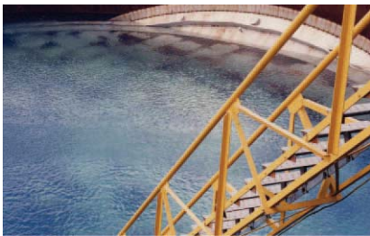
a. Roof sunk.
