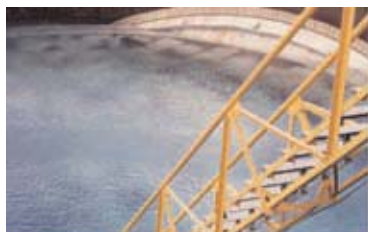
a. Roof sunk
