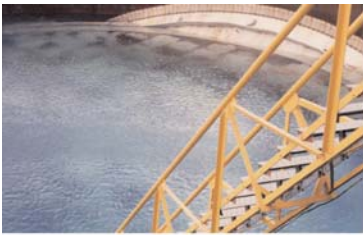
a. Roof sunk
