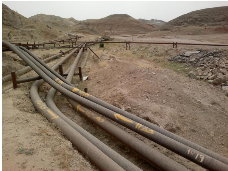
تصویر ۲۱- گذر چندین خط لوله هم سائز از یک کانال و ضرورت جانمایی قبل از عملیات
